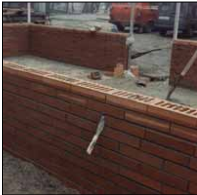
Detalle de las llagas verticales sin mortero
