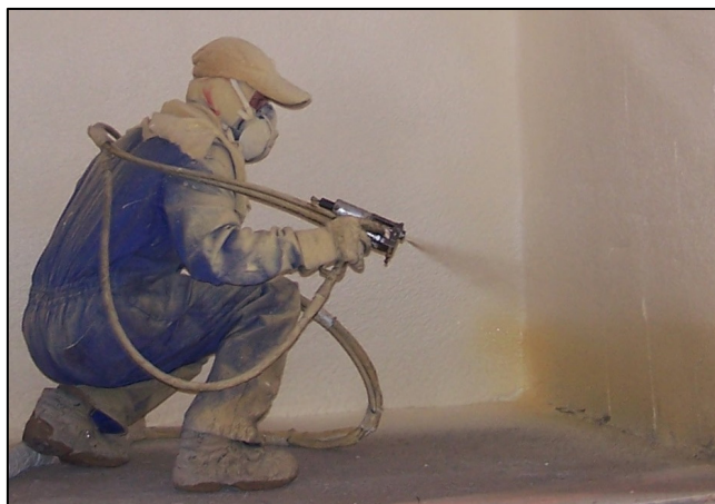
Aplicador proyectando espuma de poliuretano sobre la cara interior de la hoja exterior de una fachada.
